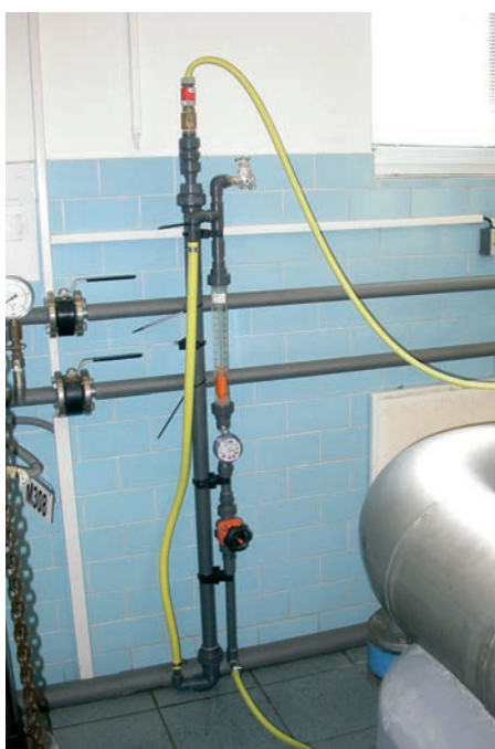
Monitor tvorby biofilmu instalovaný na čerpací stanici
