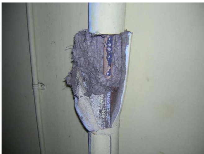
Obrázek 12.7: Azbestová izolace trubky, je vidět několik vrstev a pronikání smáčecího prostředku.
