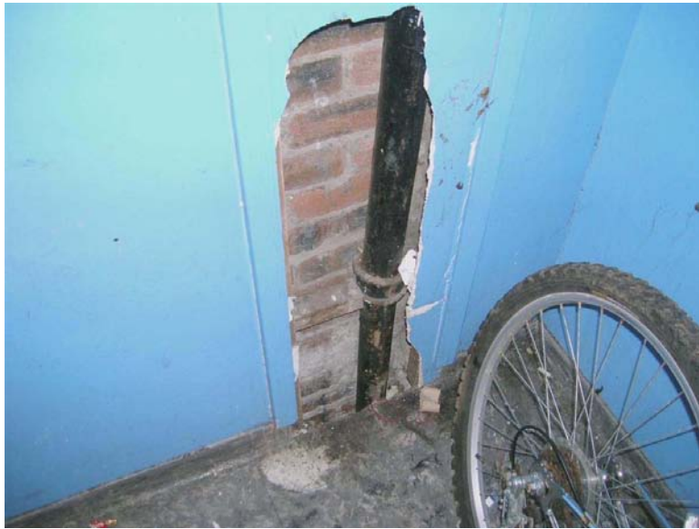
Obrázek 6.4: Azbestová izolační deska. Na tomto místě je náchylná k poškození, a proto by se mělo zvážit její odstranění.
