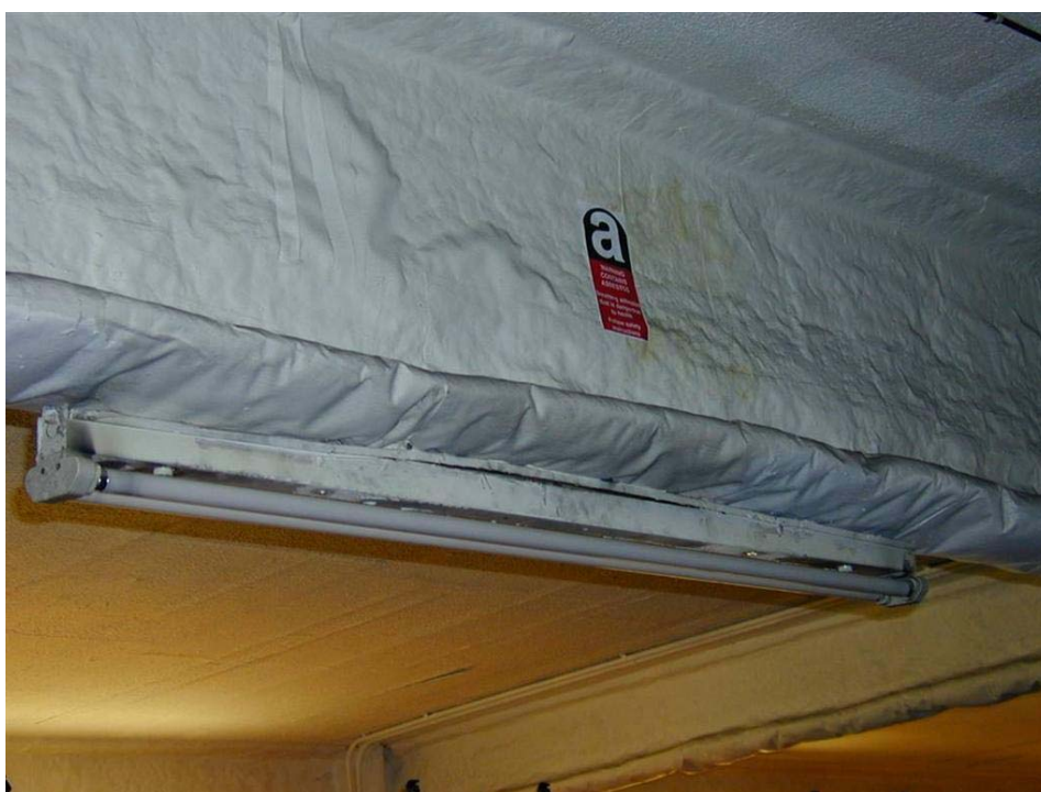
Obrázek 4.11: Azbestová izolace na nosné ocelové konstrukci.
