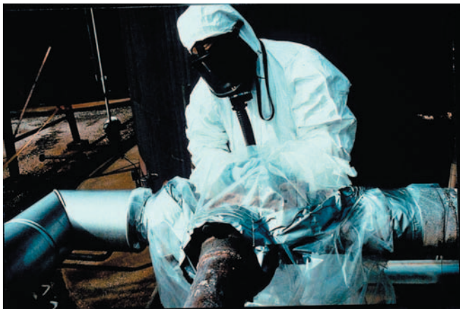
Obrázek 12.12: Kontrolované odstranění azbestového opláštění pomocí vaku s manipulačními rukavicemi (Fotografie přetištěny se svolením INRS; © copyright INRS).
