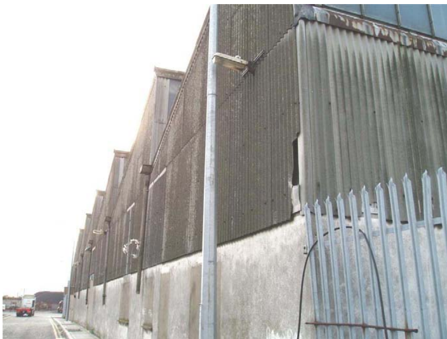
Obrázek 4.10: Azbestocementový plášť tovární zdi.
