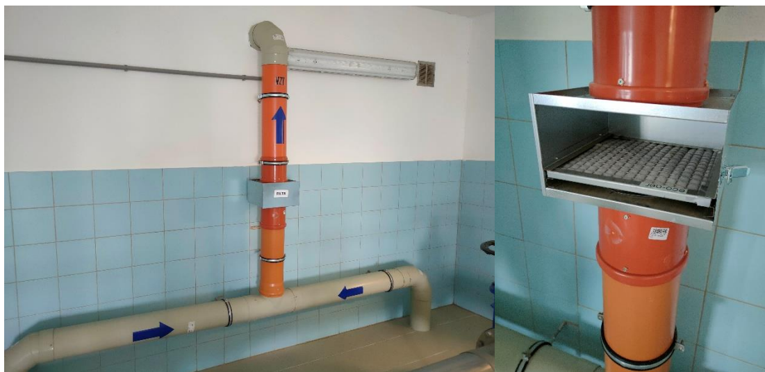
Obr. 7-4. Ventilační potrubí v objektu vodojemu s osazeným vyměnitelným filtrem vzduchu, příklad dobré praxe. Foto: Jan Ručka, VUT Brno.
