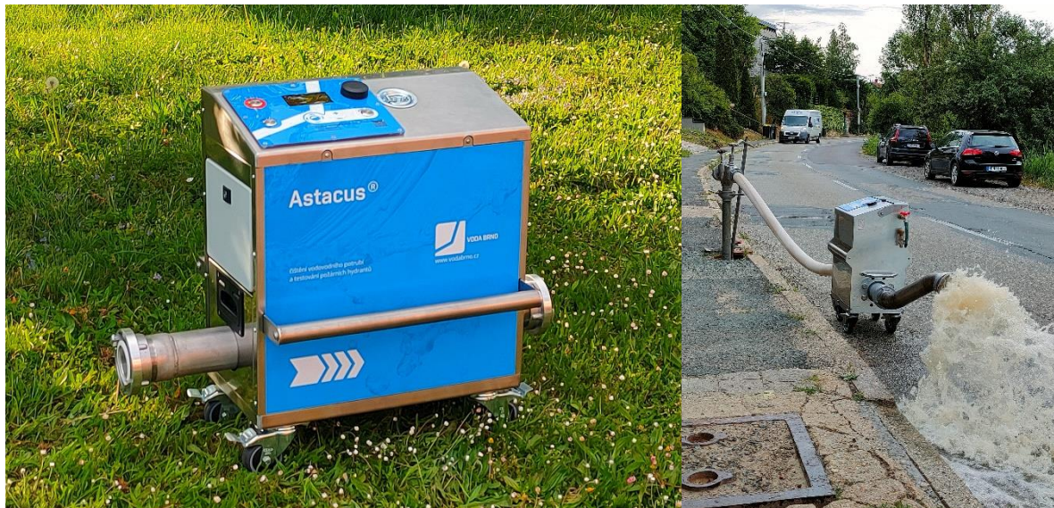
Obr. 7-6. Technologie pro čištění vodovodního potrubí, testování požárních hydrantů a měření teploty vody v potrubí (Ručka, 2024). Foto: Jan Ručka, VUT Brno.
